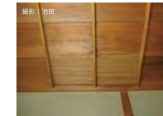
カビが発生した天井
