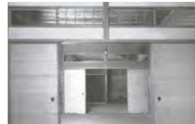
④ 客間棟（復原前）：楽室と比較すると損傷が少ないことがわかる
