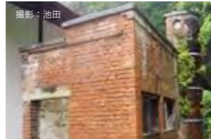
ボイラー室 外観写真
