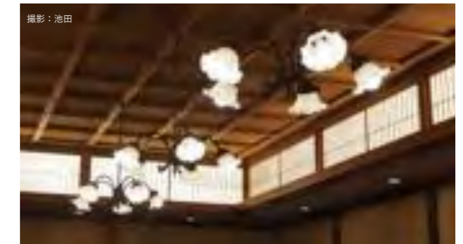
新設された大広間の照明設備
