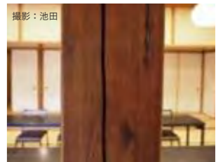
乾燥により亀裂の入った柱
